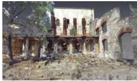
Εικ. 11: Ψηφιακή Τεκμηρίωση Μνημείου με χρήση 3D TLS: κτήριο περιστροφικών καμίνων Waelz-Krupp, υπ. κατάσταση (πηγή: αρχείο Εργαστ. Αρχ. Σχεδιασμού & Ερευνών III: Μορφολογίας – Ρυθμολογίας, TAM/ΔΠΘ).
