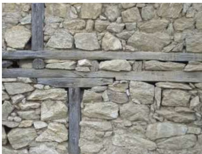
Εικ. 9: Λεπτομέρεια κατασκευής της κατοικίας Χατζηλία (περ. 1850), όπου φαίνεται λοξόμητη σύνδεση ταμπανιών και μισοχαρακτή σύνδεση ταμπανιού και μαξιλαιριού
