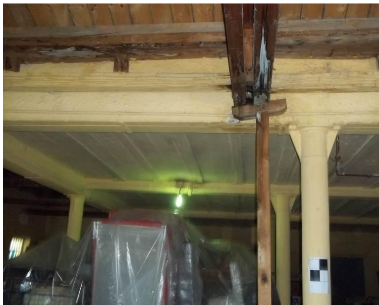
Εικ. 7: Φθορά ξύλινης στέγης Α
