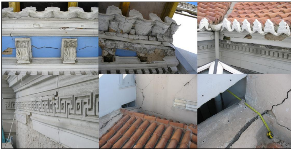
Εικ.5: Αποκολλήσεις τμημάτων τοιχοποιίας και ρωγμές στο διάκοσμο απόληξης της στέγης
