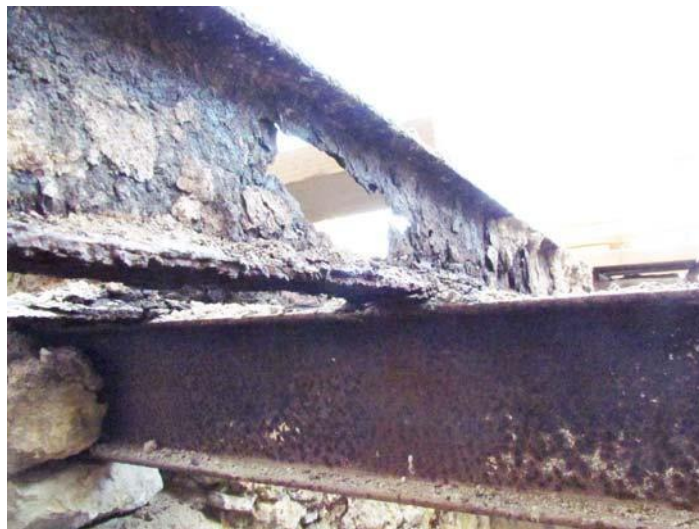
Εικ. 4: Η διάβρωση των μεταλλικών δοκών.
