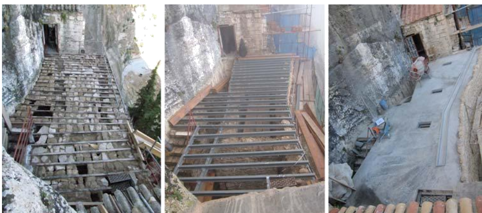
Εικ. 5: Το δώμα του προαυλίου του ναού κατά τη διάρκεια των εργασιών
