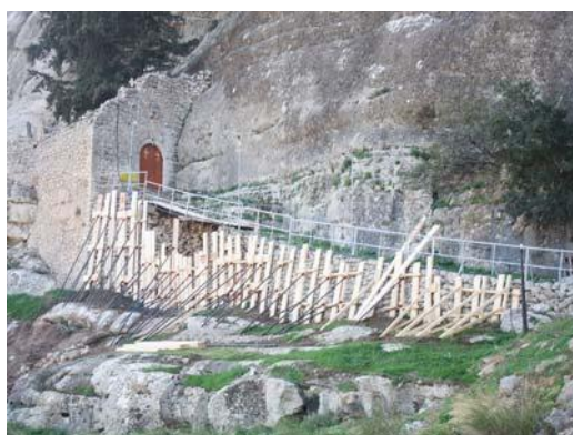
Εικ. 7: Η πρόχειρη στερέωση της ράμπας μετά την κατάρρευση
